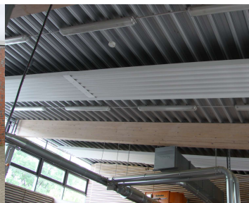
Abbildung 7 Deckenstrahler in Bauhallen
