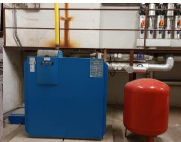
Abbildung 12 Gasheizung mit Brennwertkessel
